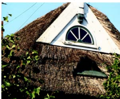
Altengammer Elbdeich 76 vor der Erneuerung des Firstes; Foto Wolfgang Eggers
